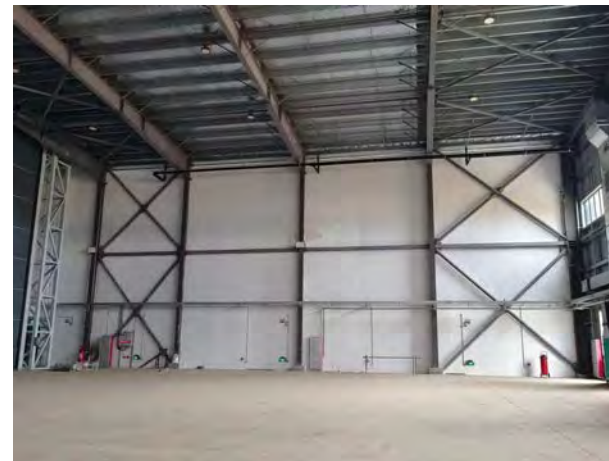
本项目喷漆房现状
